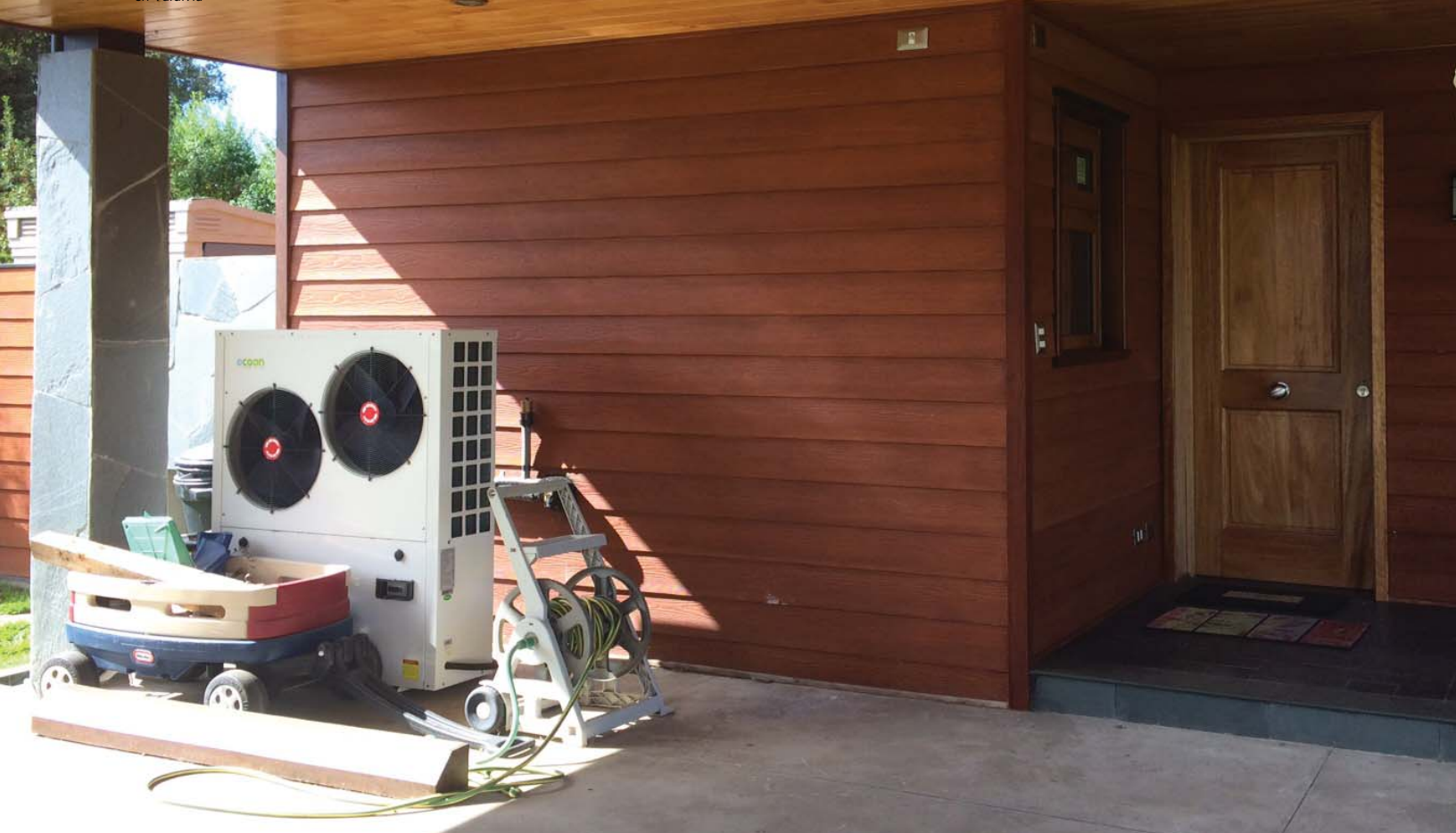
Imagen 2: Intercambiador de aire de una bomba de calor aerotermal instalada en el estacionamiento de una vivienda en Valdivia
